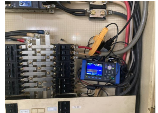
【測定器(ロガー)設置状況】
