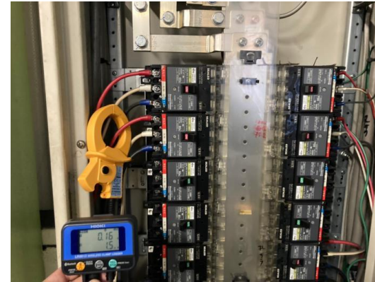
【測定器(ロガー)設置状況】
